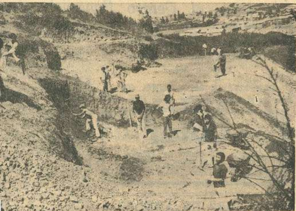
A "PURO NEQUE".— Ciento cuarenta y tres obreros reservistas trabajan en la construcción de una ruta que unirá las autopistas Carriel y Andalién. Las faenas comprenden más o menos quince kilómetros de escarpados terrenos. Las faenas se ejecutan sólo a base de picotas, palas y carretillas de mano. Carecen de máquinas por falta de petróleo. Al margen, los trabajadores están sin ningún respaldo y tienen otros problemas de carácter social. En el grabado se pueden observar las labores que se efectúan para superar un cerro.— (Más informaciones en página tres.)
